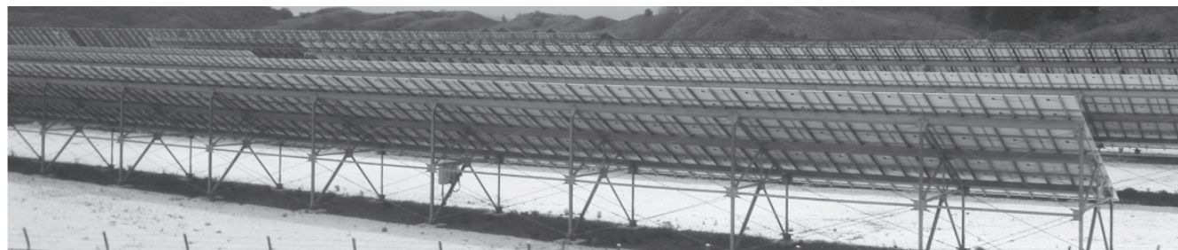
稚内メガソーラー発電所 太陽光パネル (元独立行政法人 NEDO 研究施設) 5/31
