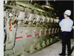
非常用ディーゼル発電機（当所の例）
