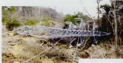
倒壊した送電鉄塔
